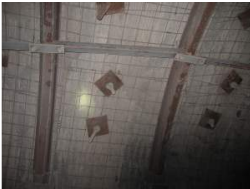
Рисунок 12 – Состояние 520 бортового штрека
