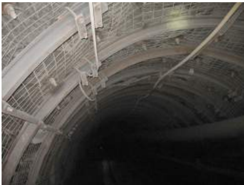
Рисунок 10 – Состояние 341 бортового штрека
