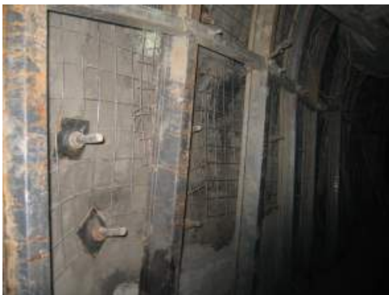
Рисунок 20 – Состояние 2-го западного откаточного штрека
